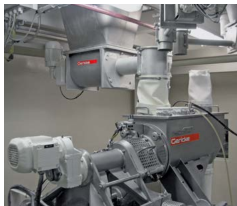
Installation de mélange en continu
