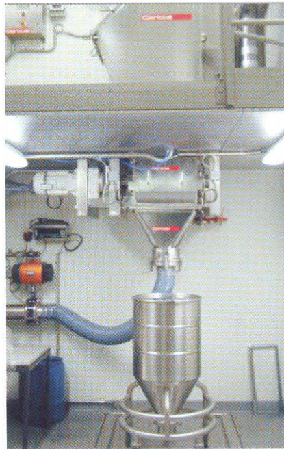
Sackaufschüttung mit Knollenzerkleinerung; ausgerüstet für CIP-Reinigung
