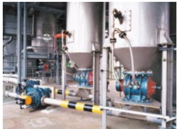
Produktaufgabe aus Silo mittels Durchfallschleuse und Aufgabeschuh.
