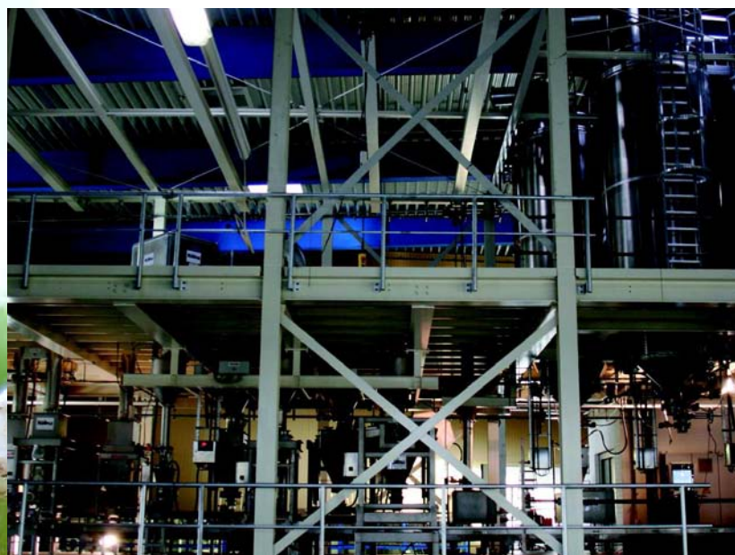
Steigende Qualitätsansprüche der Verbraucher zwingen die Lebensmittelindustrie zu neuen anlagentechnischen Lösungen
