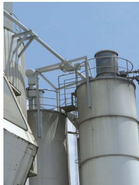
Vor dem Siloeintritt wurde eine spezielle Siloeinlaufstation installiert, die den Zement schonend und verschleißarm in das Silo umlenkt
