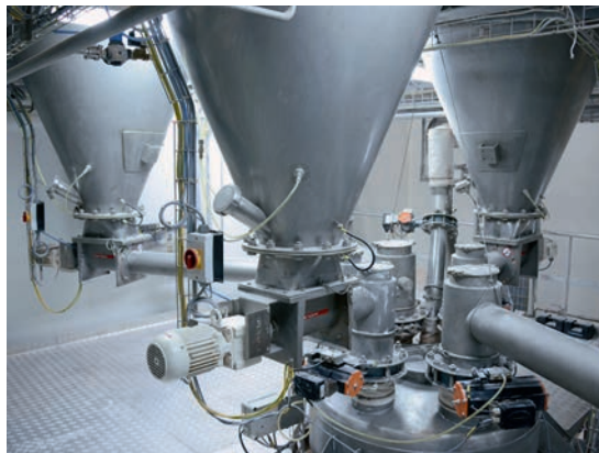
Dosificación directa en el reactor
